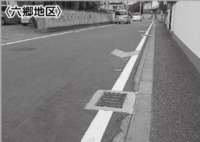
〈六郷地区〉 県道・高崎橋名吾妻線の振動対策として、集水弁と舗装面の段差を解消しました。
