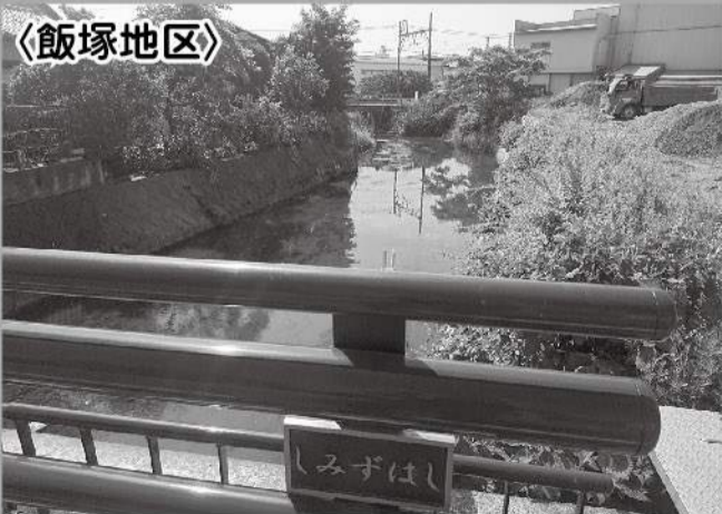
〈飯塚地区〉 一貫堀川の増水対策として、清水橋下流に大量に堆積していた土砂を除去しました。
